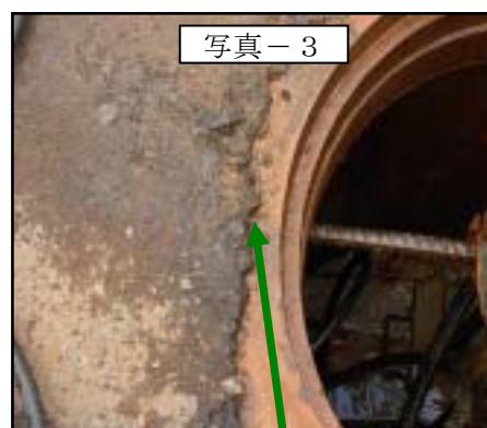
炭酸ガスが吹き出した隙間
